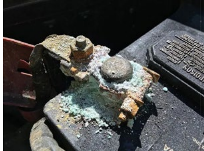
PRIMJER NEISPRAVNOSTI: KORODIRANI ELEKTRIČNI SPOJEVI AKUMULATORA
