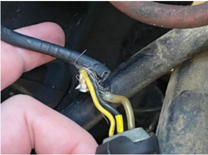
PRIMJER NEISPRAVNOSTI: OŠTEĆENA ELEKTRIČNA INSTALACIJA
